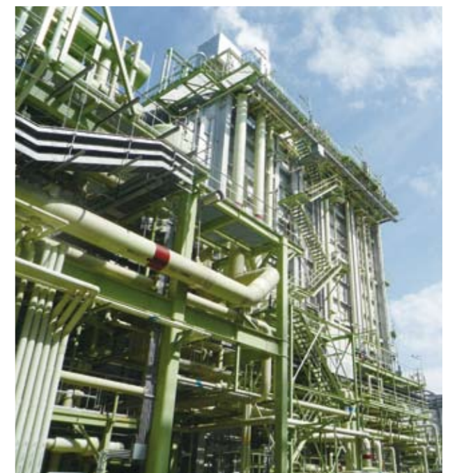
■2号排熱回収ボイラ
